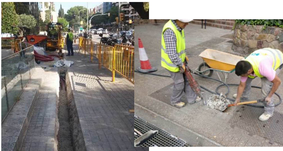
Exemples Canalització Convencional en àmbit municipal.
