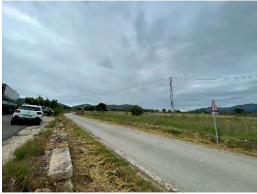
Imatge 23. Marges amb murs de pedra en mal estat en el condicionament del tram de la TV-3313.
