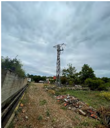
Imatge 28. Torre de mitja tensió al PK 0+143,86 .
