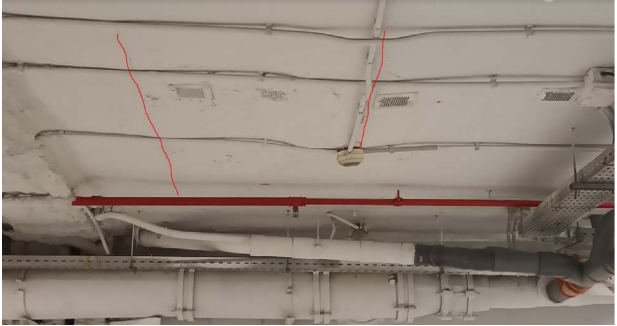
Esquerdas al sostre del soterrani -2 a la zona 3.
