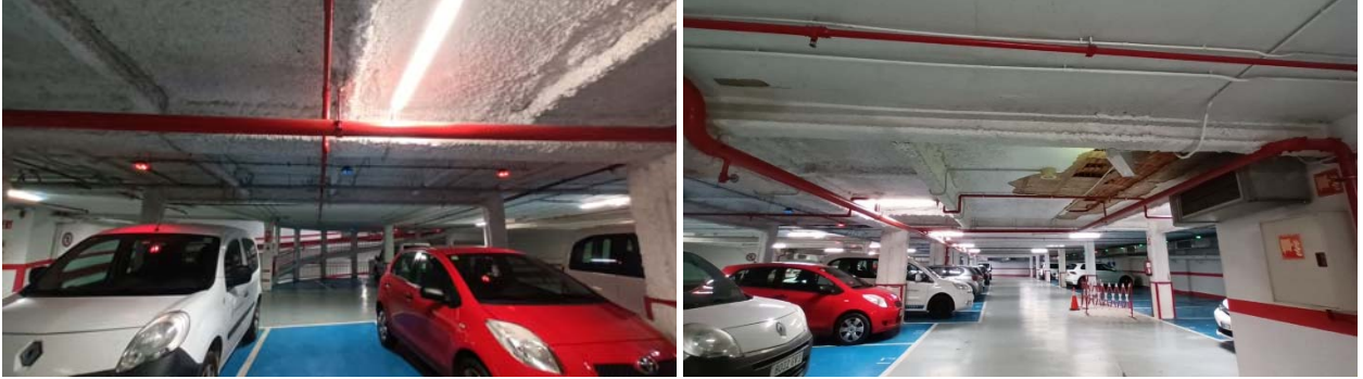
Vistes de la planta soterrani: zona reforçada i zones afectades per desprendiments
