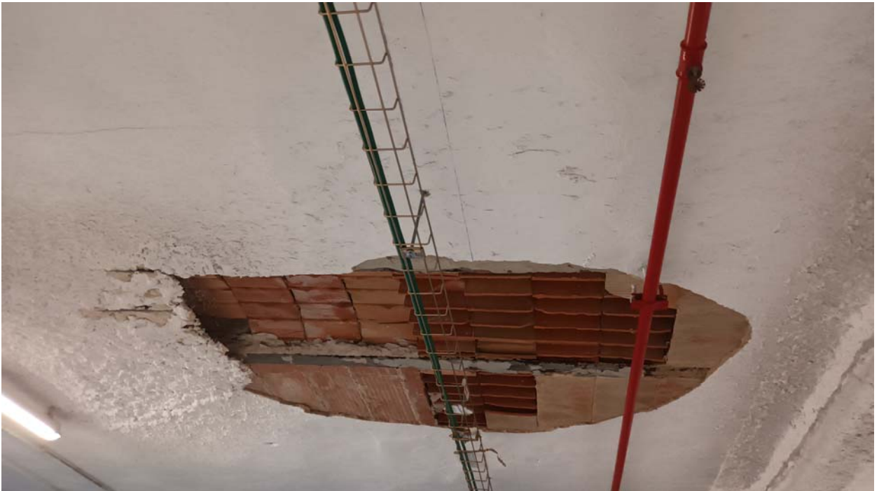
Despreniments de la Zona 2
