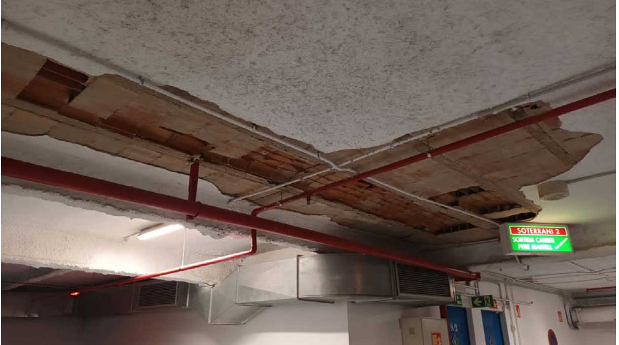
Despreniments de la Zona 1
