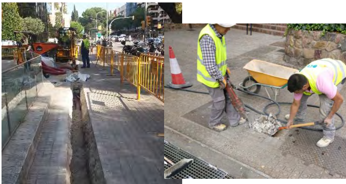
Exemples Canalització Convencional en àmbit municipal.
