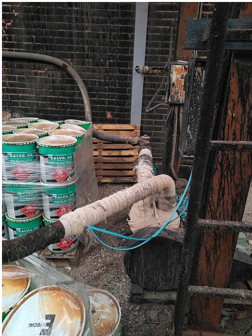
Figura 22 Vista de les canonades de la instal·lació a la paret de la nau
